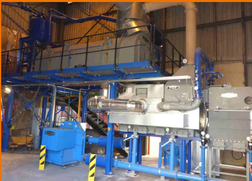
Bild 1: FAT - Thermische Regenerieranlage
