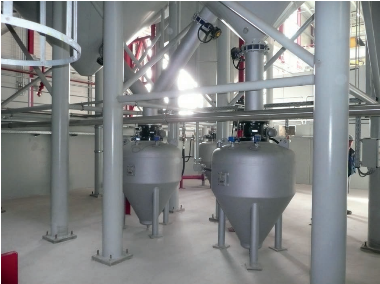
pneumatische Sandversorgung mit FAT-Schubförderern
