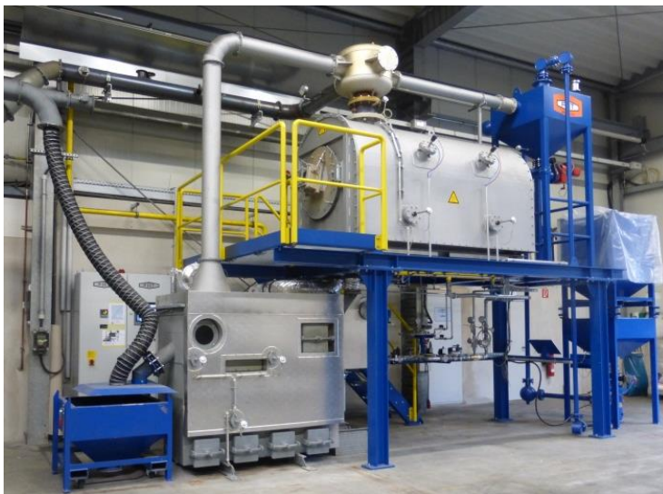
Bild 6: Testanlage im FAT Werk in Niederfischbach
